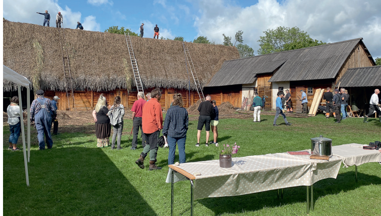
2 september 2023 omryftades agtaket på bulhusladugården. Färö Täckarlag hade ansvaret under ledning av Åke Olsson, men många andra deltog eller tittade på. På bordet står en av kalopsgrytorna kvar sedan middagen.
